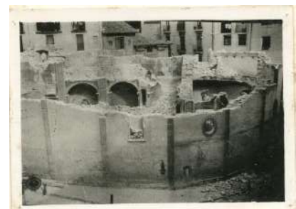
7 Enderrocament de l'església de Sant Eudald (Autor J. Fosses. Arxiu Comarcal del Ripollès)
